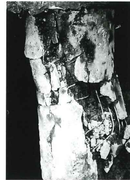
杭頭を剛接した杭の被害例
